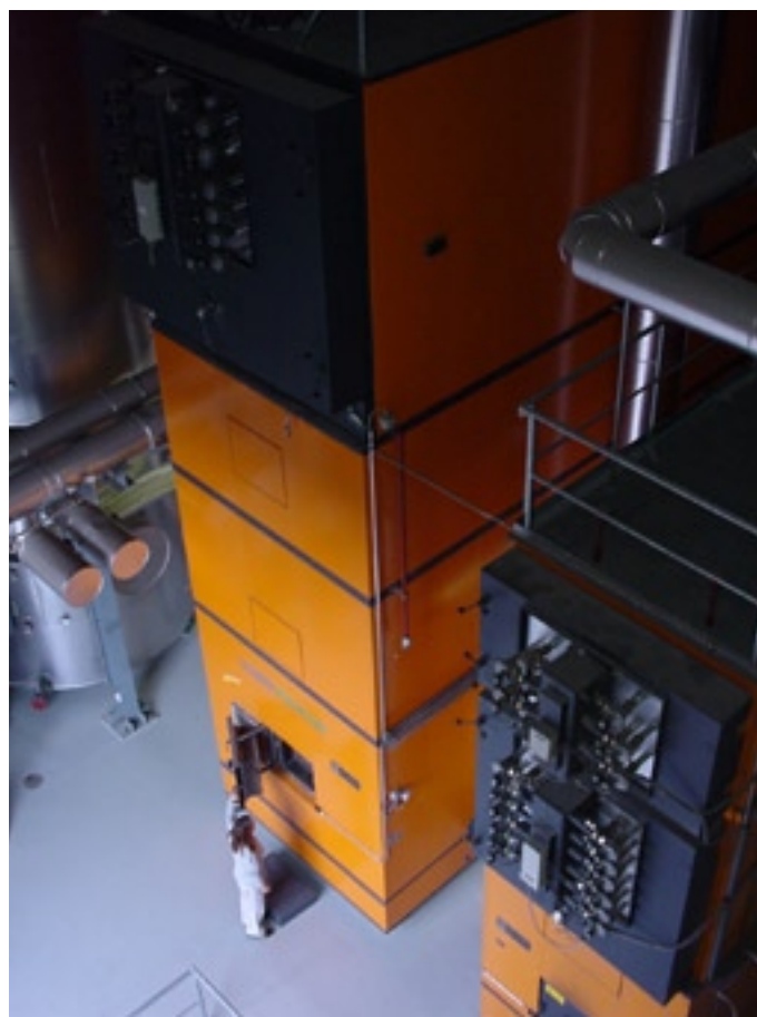
Die Holzheizkessel leisten 2500 und 5500 kW. Installiert ist auch ein Ölheizkessel mit 2700 kW sowie eine Notanlage mit 3600 kW.
